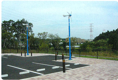
公園の高台にある駐車場には、3基の発電用風車が設置されています。電力は揚水ポンプや噴水などに使用されています。
