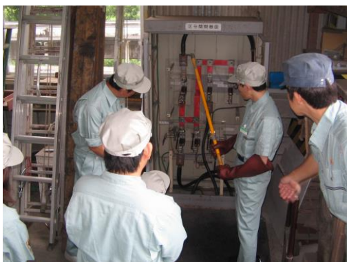
【車両基地検修所内 区分開閉器 操作訓練】
