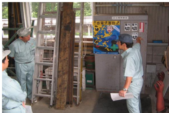
【車両基地検修所内 区分開閉器 表示説明】
